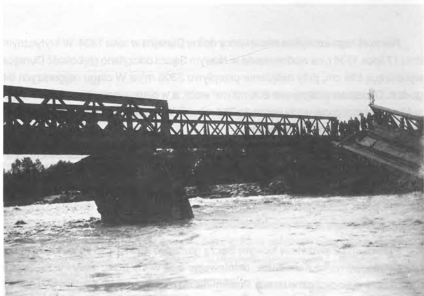
Lipiec 1934 r. Zerwane przęsło i uszkodzony most na rzece Kamienica w Jamnicy. Fot. ze zbioru Ryszarda Krzeszowskiego
