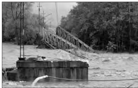
Zerwany most kolejowy na Popradzie
