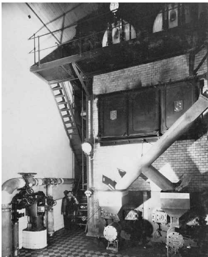
Ryc.7. Kotłownia elektrowni przy Nowych Łazienkach Mineralnych. Kocioł sosnowieckiej firmy: Fabryka Kotłów Parowych W. Fitzner i K. Gamper. Fot. ze strony: https://polska-org.pl/7334266,foto.html?idEntity=7334228 w dniu 3.07.2020
