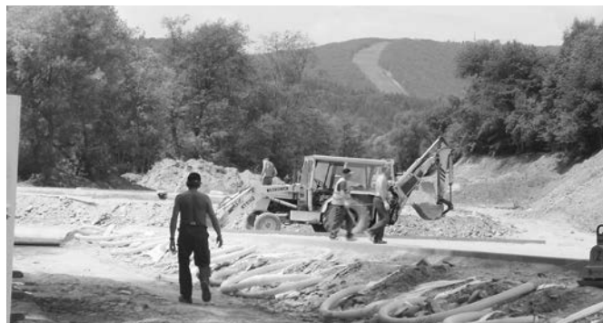
Budowa kompleksu sportowo - rekreacyjnego dla dzieci i młodzieży na osiedlu Czarny Potok.
